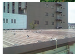
屋根に設置された散水設備
