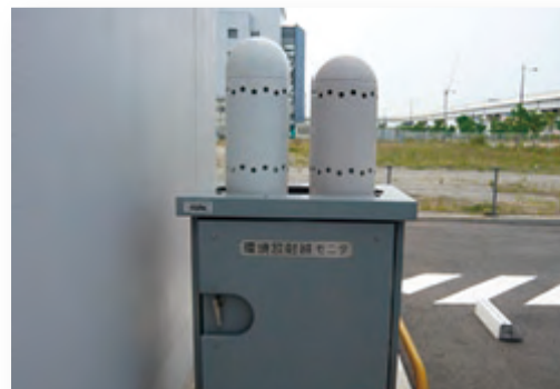
排気中の放射性物質濃度を測定する排気モニタ
