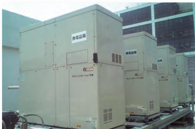
神戸MI R&Dセンターに導入されたコージェネレーション設備
