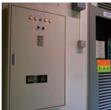
各部屋に設置された電力の計測機能を備えた実験用分電盤
